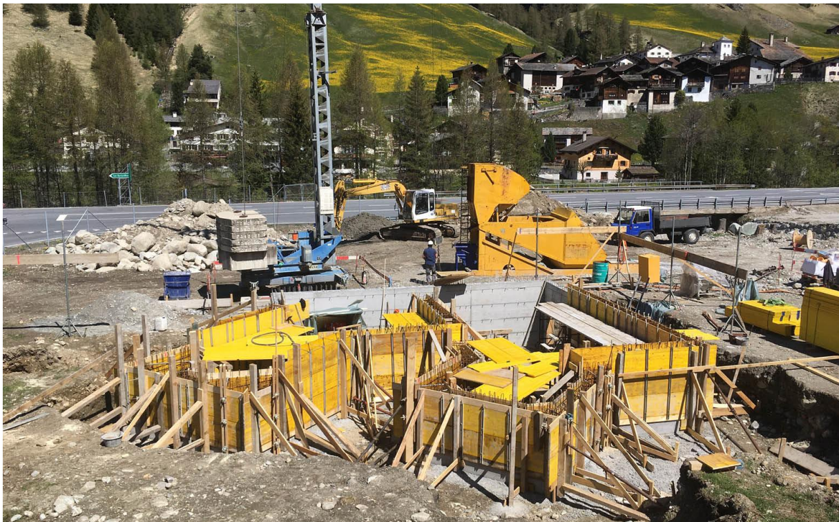
Maschinenhaus Kraftwerk Tambobach
